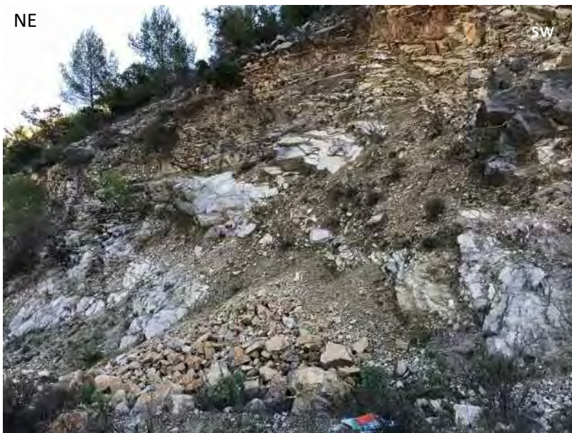
Figure 22 : Zone d'éboulements liée à un pendage défavorable le long de la piste d'accès à la plate-forme sommitale
