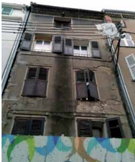
Des biens très dégradés
